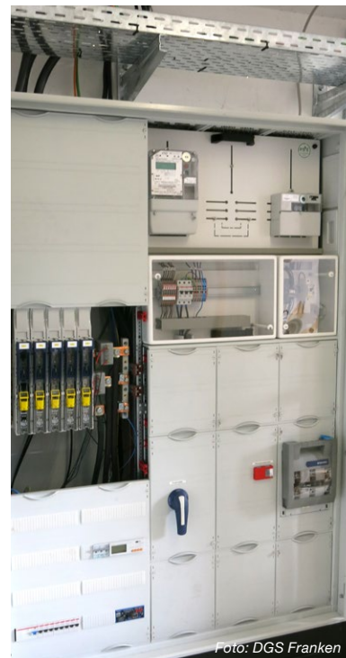
Abbildung 6. Die Kosten und der Platz für den Wandlerschrank für die Umsetzung eines physischen Summenzählermodells ab ca. 4 bis 5 Wohneinheiten sollen im Angebot des Solarteurs betrachtet und müssen in der Vorplanung berücksichtigt werden.
